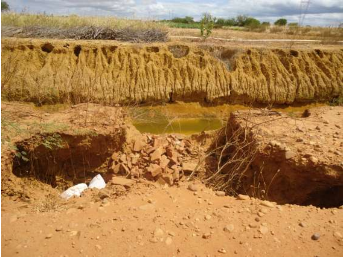
Fig. 7: Paredes de um dreno de perímetros irrigados, desbarrancadas por falta de proteção.
